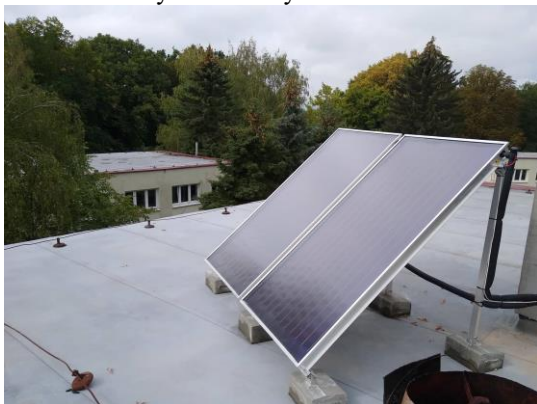
Obr. 1: Solárny ohrev vody
